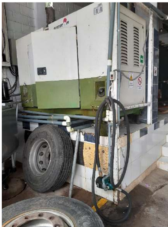
FOTOGRAFÍA 9 CALDERO FUENTE: EQUIPO CONSULTOR
