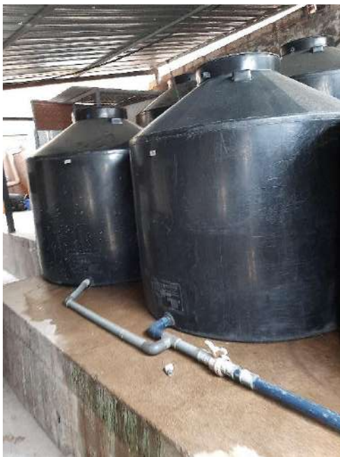
FOTOGRAFÍA 11 TANQUES DE ALMACENAMIENTO FUENTE: EQUIPO CONSULTOR
