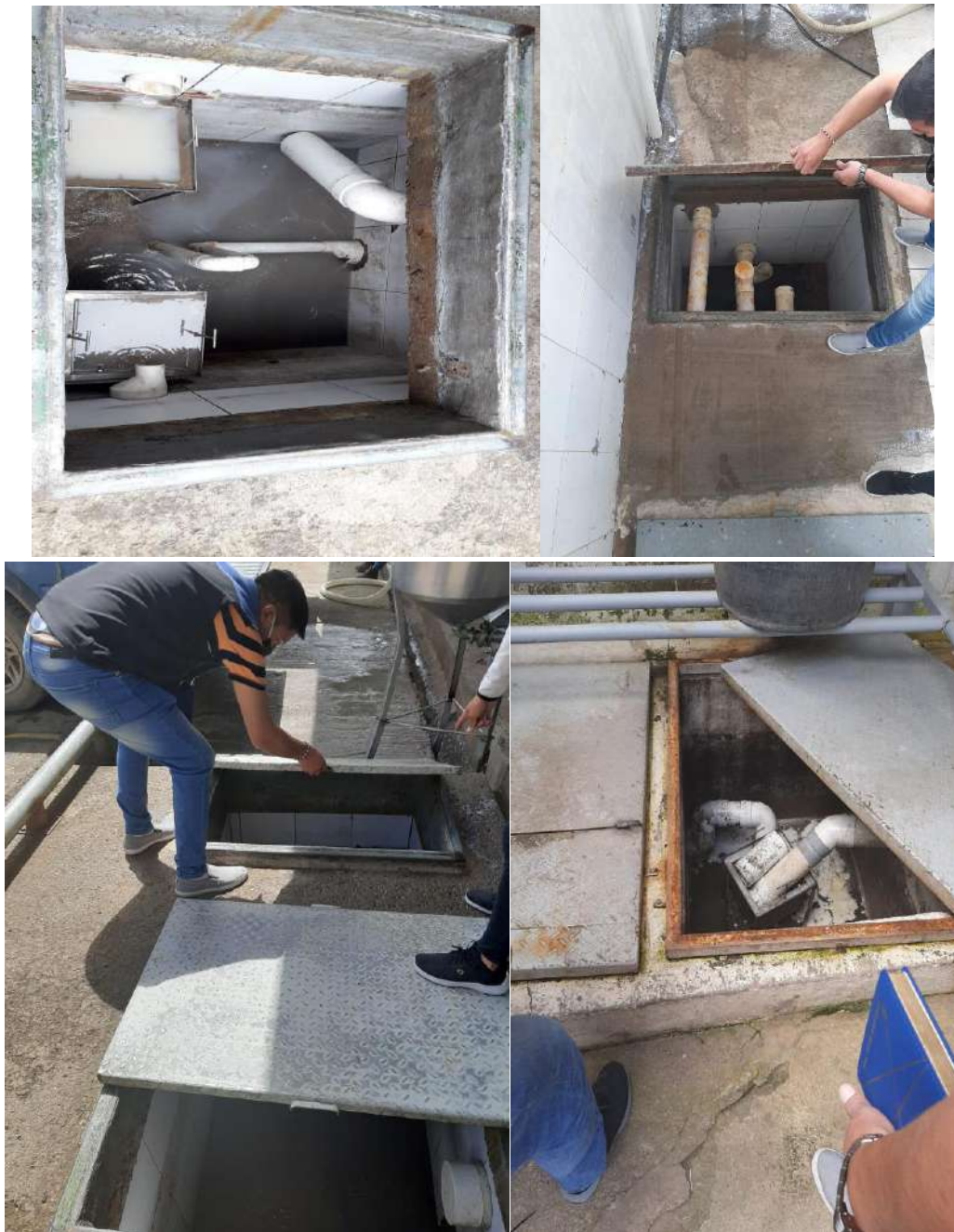
FOTOGRAFÍA 6 TRAMPAS DE GRASA FUENTE: EQUIPO CONSULTOR
