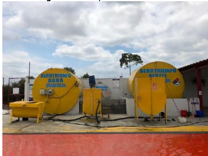
Imagen 8.10 Tanques de almacenamiento
