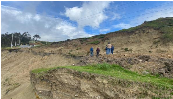
Zona del deslizamiento y derrumbes en la calzada de la vía
