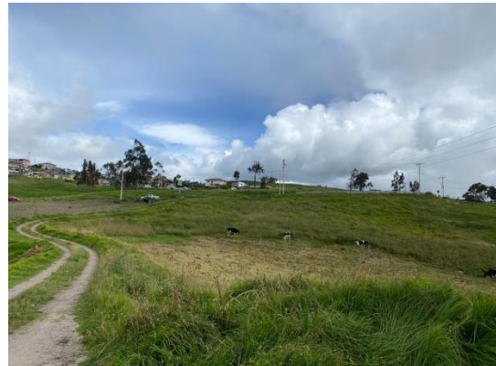
Sector de desfogue de dos alcantarillas con presencia de micro deslizamientos y hundimientos
